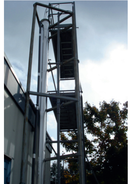
Versuchsanlage zur Ammoniakstrippung. Foto: Julia Alexeeva-Steiniger
