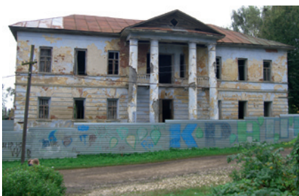
Ruinös – eines der Gebäude mit ehemals öffentlicher Nutzung
