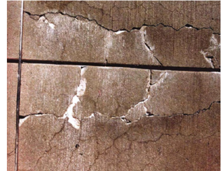
Alkali-Kieselsäure-Reaktion-Schaden (AKR) an einer Fahrbahndecke (Autobahn) aus Beton: Risse und Abplatzungen.
