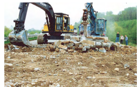
Abbruch einer AKR-geschädigten Fahrbahn aus Beton. Eine Sanierung ist nicht mehr möglich.
