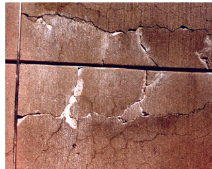
Alkali-Kieselsäure-Reaktion-Schaden (AKR) an einer Fahrbahndecke (Autobahn) aus Beton: Risse und Abplatzungen.
