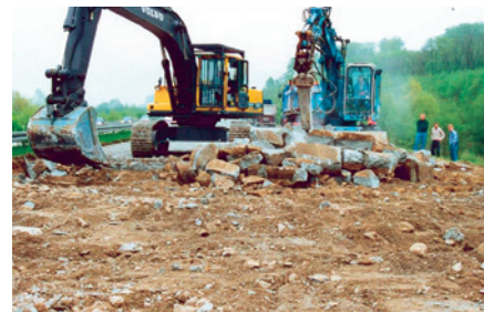
Abbruch einer AKR-geschädigten Fahrbahn aus Beton. Eine Sanierung ist nicht mehr möglich.
