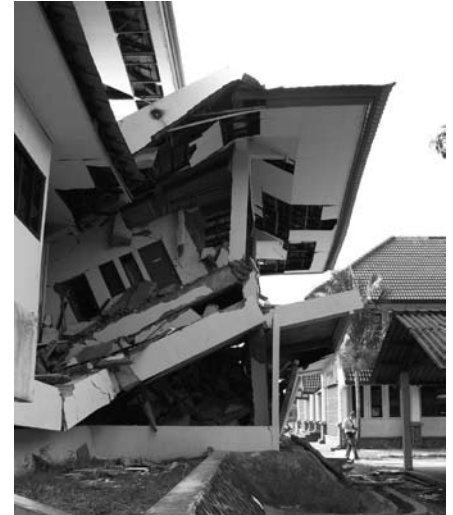
Einsturz des Erdgeschosses eines Gebäudes der Hochschule ISI (Institut Seni Indonesia) durch das Erdbeben vom 27. Mai 2006 in Yogyakarta, Indonesien.
