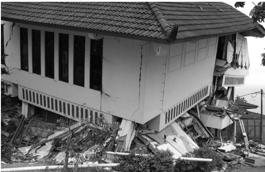
Stockwerksversagen des Verwaltungsgebäudes BPKP (Badan Pengawasan Keuangan dan Pembangunan) durch das Erdbeben vom 27. Mai 2006 in Yogyakarta, Indonesien. Fotos: Tom Swain, Erdbebenzentrum
