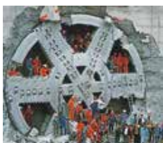
Steuerung von Tunnelvortriebsmaschinen
