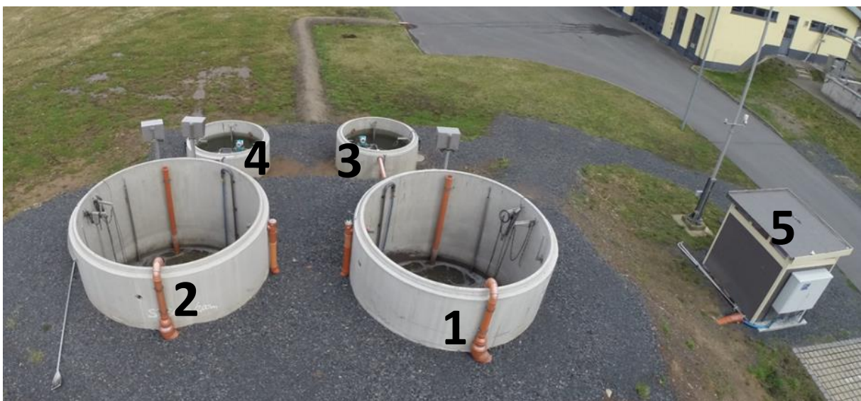
Abbildung 2 – Versuchskläranlage zur Reinsauerstoffnutzung aus der Wasserelektrolyse, (1 – Belebungsbecken 1; 2 – Belebungsbecken 2; 3 – Nachklärbecken 1; 4 – Nachklärbecken 2; 5 – Maschinenhaus mit Anlagen zur Luft- sowie Reinsauerstoffversorgung und EMSR-Technik).
