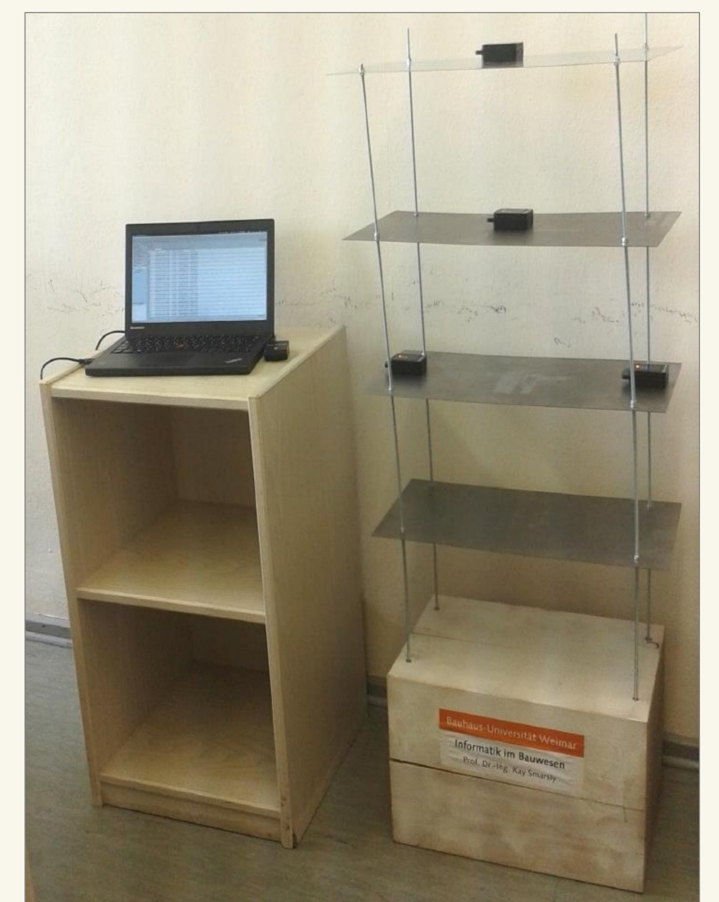
Abb. 3: Implementierung des Bauwerksmonitoringsystems
