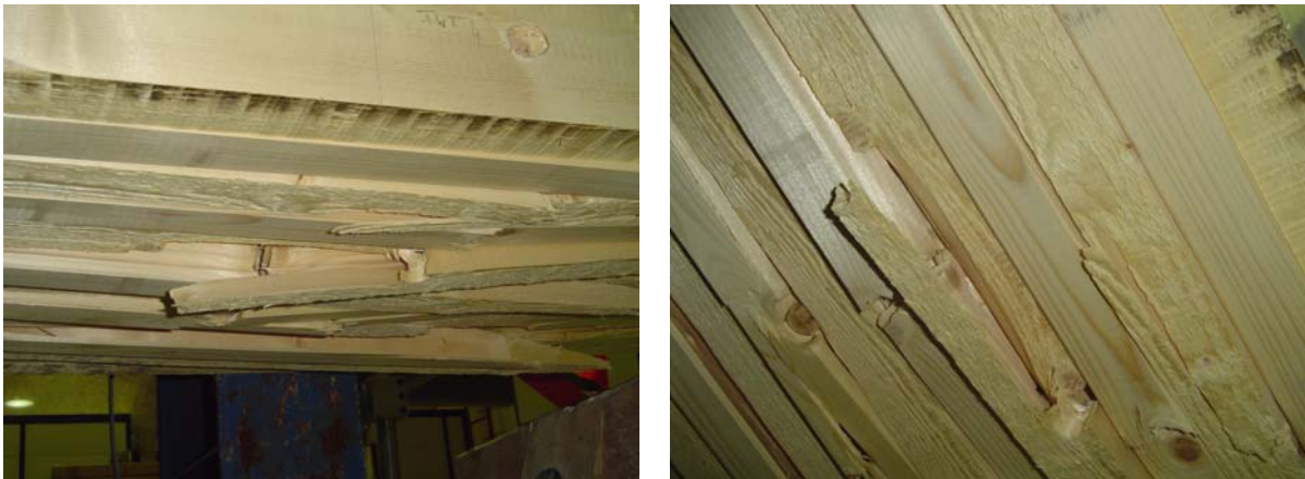
Abb. 96 Bruchursache: Biegezugversagen des Holzes
