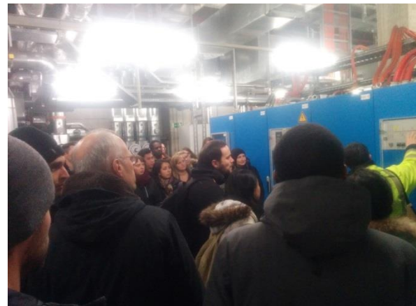
Technikräume im Airport Frankfurt
