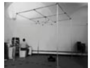
Ultraschall-Sensoren unter der Decke
