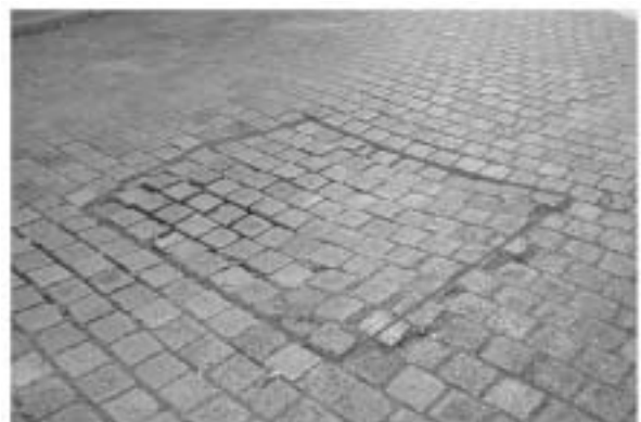
Abb. 1.19: Senkungsmulde in Pflasterdecke nach Reparaturarbeiten an Trinkwasserleitungen
